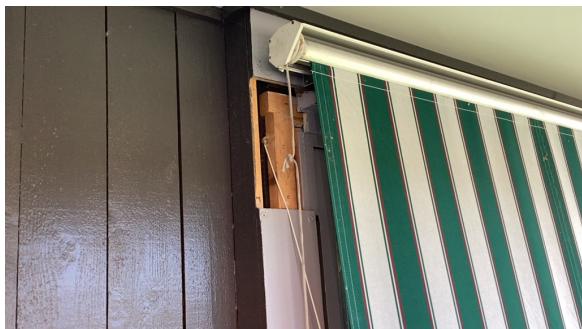
Mangler en fasadeplate.
