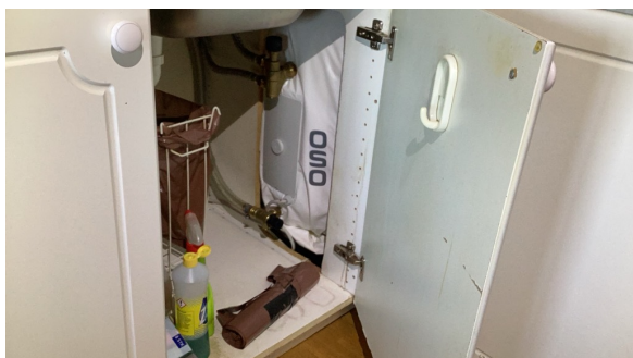
Varmtvannstank i kjøkkenskap.
