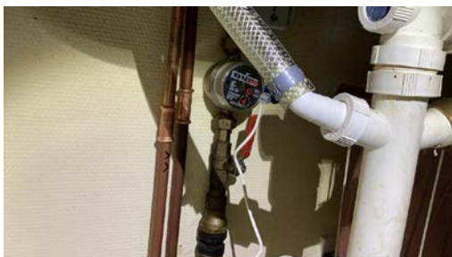
Stoppekran og vannmåler i kjøkkenskap.
