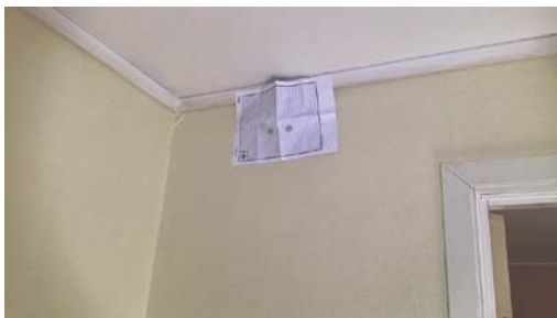
Avtrekksvifte er testet som beskrevet i NS3600.
