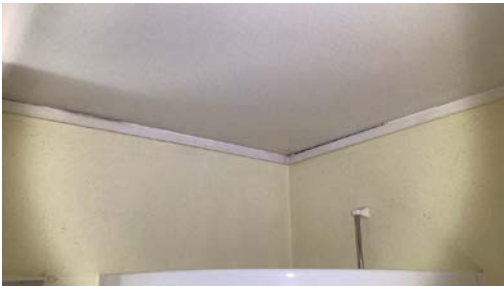
Sprekt fuge mellom taklist og himling.
