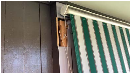
Mangler en fasadeplate.
