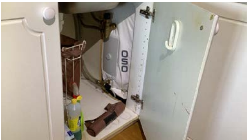
Varmtvannstank i kjøkkenskap.
