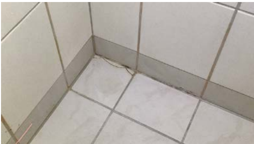
Sprekt flis i dusjsone.
