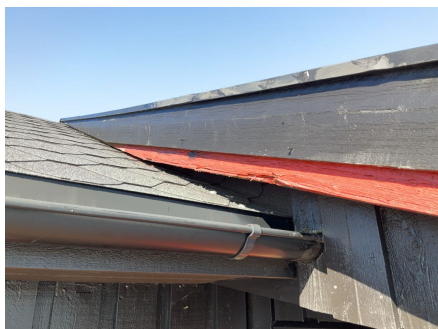
Råteskadet treverk i vindski er registrert.
