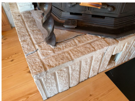
Riss/sprekker i fundamenter og pipe.
