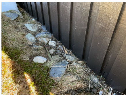
Lav høyde mellom grunnen og kledning. Risiko for skader på kledning. Anbefalt høyde mellom terreng og kledning er 30cm.
