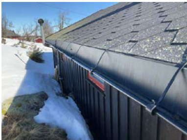
Yttertaket har nedbøying.
