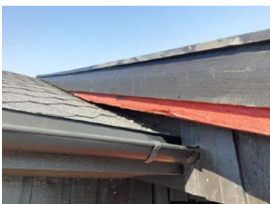
Råteskadet treverk i vindski er registrert.
