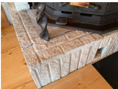
Riss/sprekker i fundamenter og pipe.
