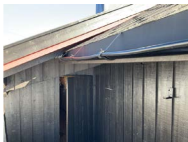
Takrenne er bøyd/deformert etter snøras eller ising i renne.
