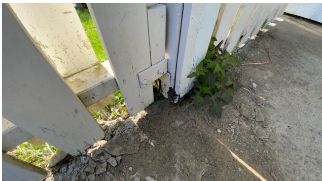
Det er påvist råteskader i konstruksjonen.
