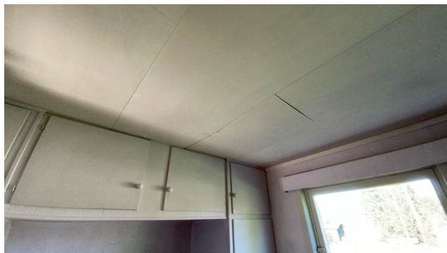
Skadet innvendig takflate i 1.etg.
