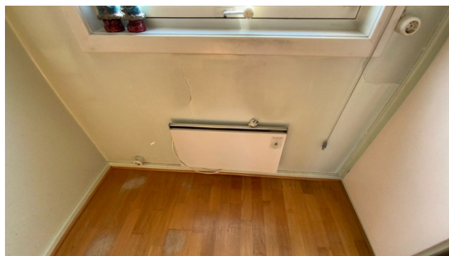
Synlige riss på vegger.
