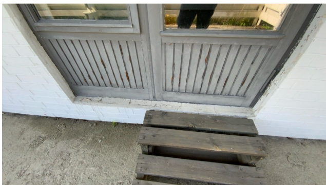
Dører har råteskader.
