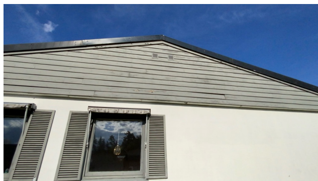
Synlig elde, slitasje og skader.
