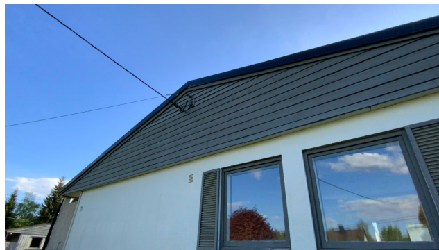
Synlig elde, slitasje og skader.
