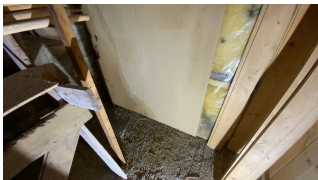
Skader på vegger i kjeller.
