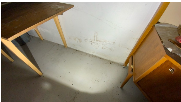
Stedvis behov for lokale utbedringer.
