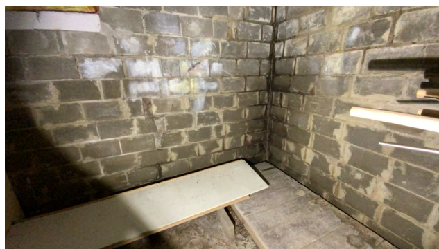
Stedvis behov for lokale utbedringer.
