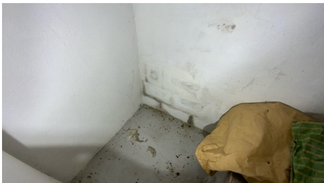
Stedvis behov for lokale utbedringer.
