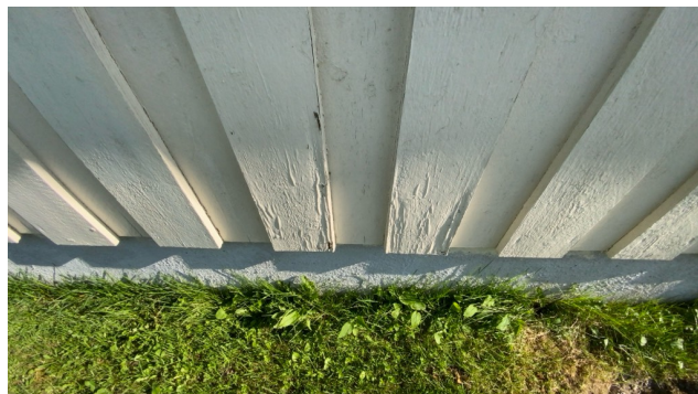
Synlig elde, slitasje og skader.
