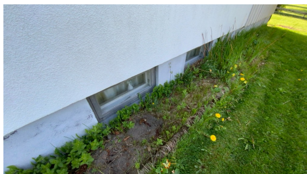
Synlige skader på vinduer.
