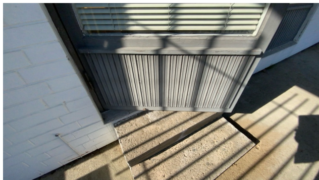
Dører har råteskader.
