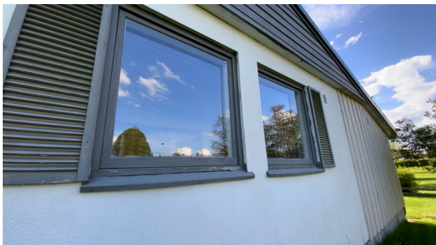
Synlige skader på vinduer.
