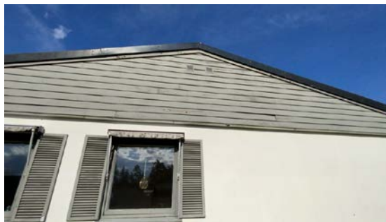
Synlig elde, slitasje og skader.
