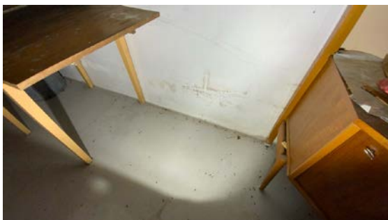
Stedvis behov for lokale utbedringer.
