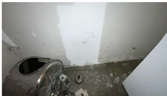
Synlig saltutslag på vegger.
