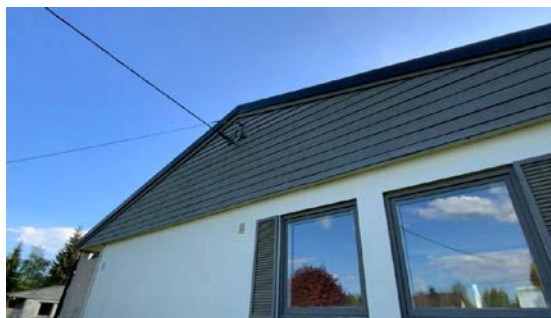
Synlig elde, slitasje og skader.
