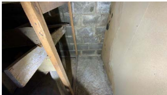
Stedvis behov for lokale utbedringer.
