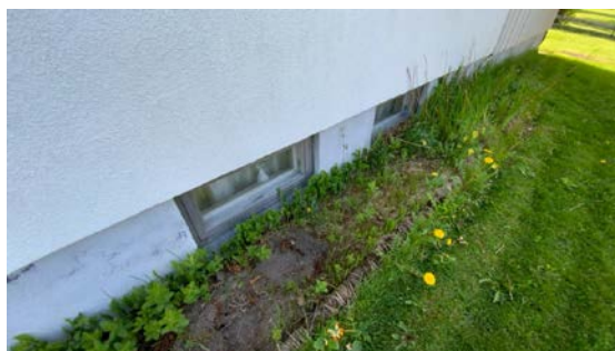
Synlige skader på vinduer.
