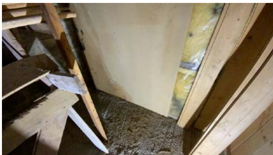
Skader på vegger i kjeller.
