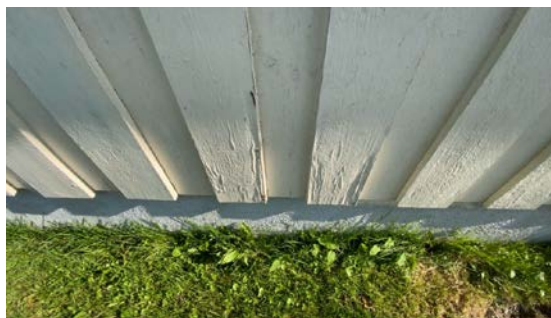
Synlig elde, slitasje og skader.
