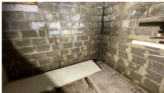
Stedvis behov for lokale utbedringer.
