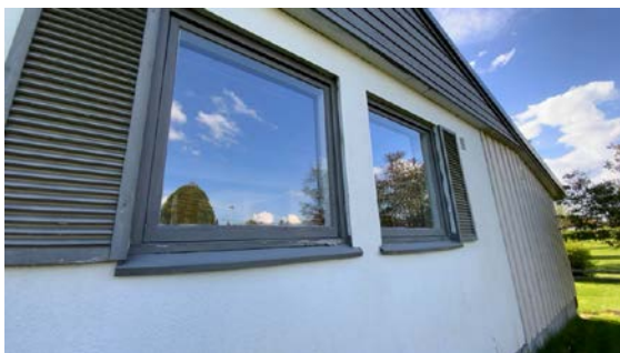
Synlige skader på vinduer.
