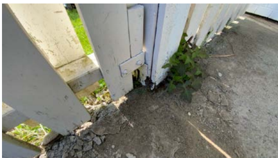
Det er påvist råteskader i konstruksjonen.
