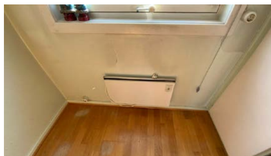
Synlige riss på vegger.
