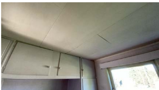
Skadet innvendig takflate i 1.etg.
