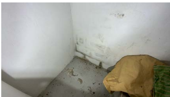
Stedvis behov for lokale utbedringer.
