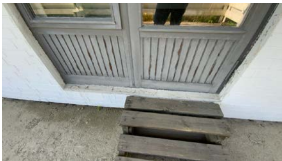
Dører har råteskader.
