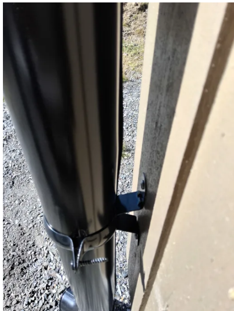
Det registreres buling på et nedløpsrør.
