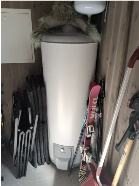
Varmtvannsbereder er plassert i bod/teknisk rom.
