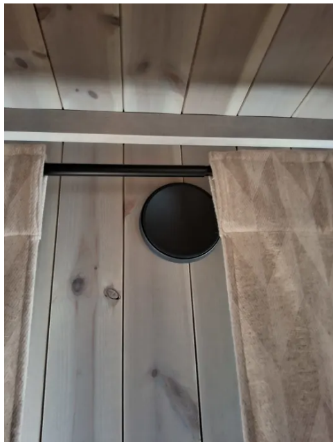
Ventiler er plassert på yttervegg.
