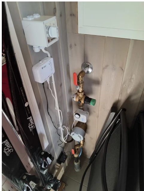
Hovedstoppekran er plassert i bod/teknisk rom.
