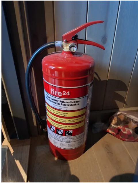
Brannslukningsapparat er plassert i bod under trapp.
