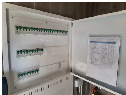
Sikringsskap er plassert i bod/teknisk rom.
