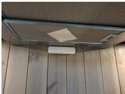
Avtrekkseffekt er testet med papir.
