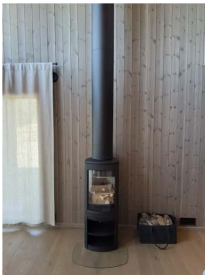
Vedovn med glassdør i stue.
