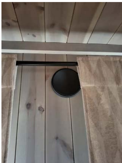
Ventiler er plassert på yttervegg.
