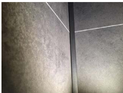
Det registreres glippe mellom våtromsplate og hjørneprofil i dusjsonen.
