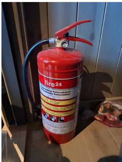
Brannslukningsapparat er plassert i bod under trapp.
