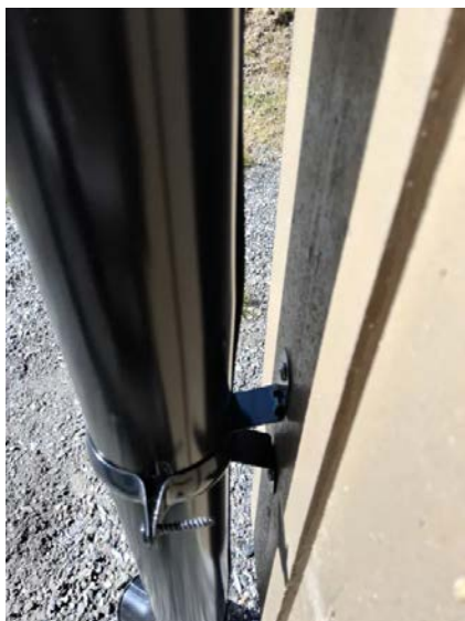
Det registreres buling på et nedløpsrør.
