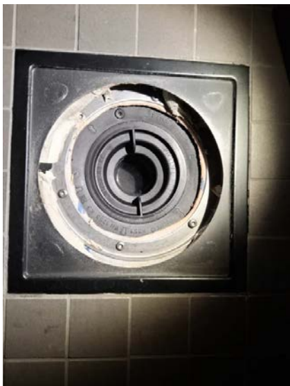
Det ble ikke avdekket avvik i overgang mellom sluk/membran.
