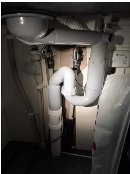
Synlige avløpsrør av plast.
