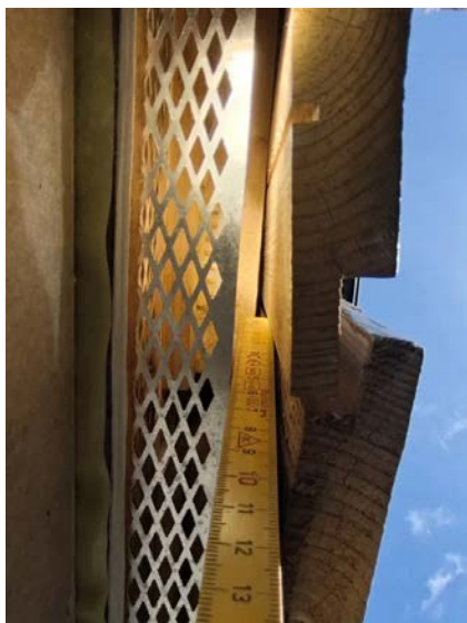
Det registreres gliper mellom musetetting og kledningens bakside.
