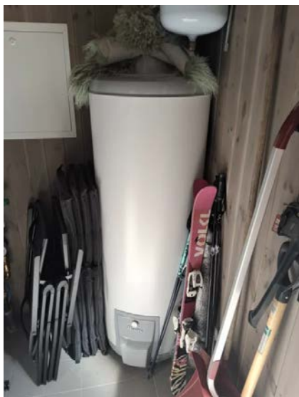
Varmtvannsbereder er plassert i bod/teknisk rom.
