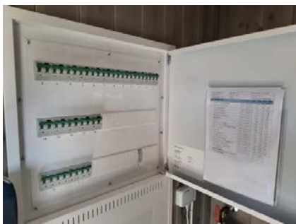
Sikringsskap er plassert i bod/teknisk rom.
