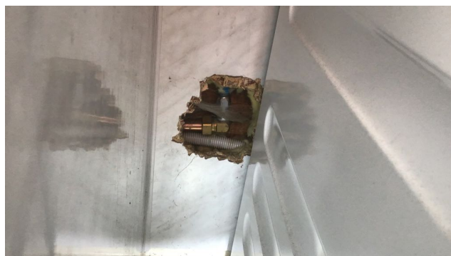
Hull i vegg bak vaskemaskin
