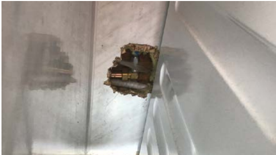
Hull i vegg bak vaskemaskin
