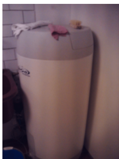
Nyere bereder er plassert på vaskerommet
