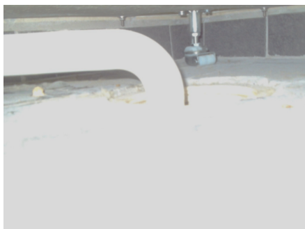
Sluk under dusjkabinett.
