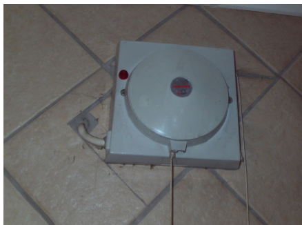
Eldre vifte i ytterveggen.
