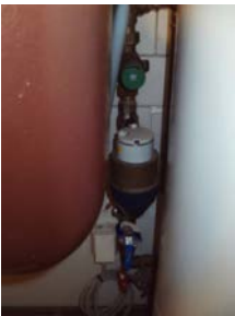
Innvendig stoppekran med vannmåler på vaskerommet.
