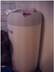
Nyere bereder er plassert på vaskerommet
