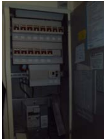
Sikringsskapet er plassert i vindfang.
