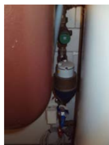
Innvendig stoppekran med vannmåler på vaskerommet.
