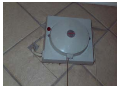
Eldre vifte i ytterveggen.
