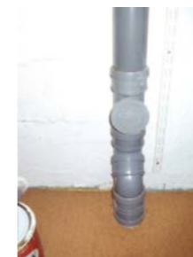
Avløpsrør av plast med stakeluke
