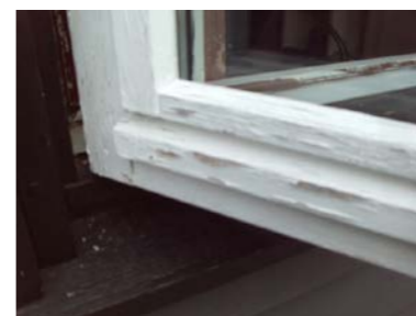
Noe utvendig vedlikehold må beregnes på enkelte vinduer.
