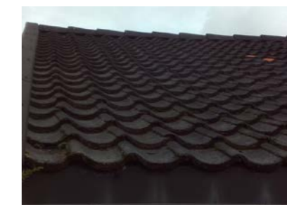
Har fått en del slitasje på selve taksteinen.
