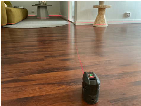
Nivellering stue + soverom, avvik
