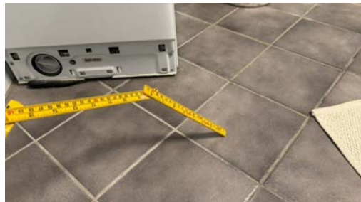
Det er bomlyd på fliser i dette området
