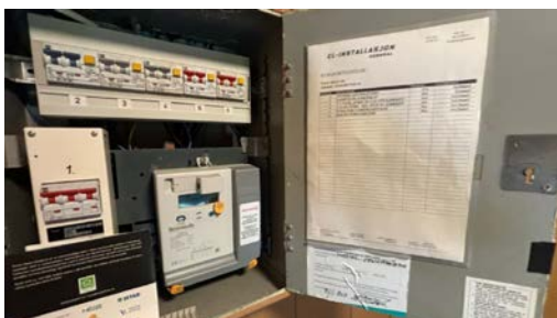
Sikringsskapet er plassert i fellesarealet
