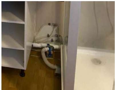
Røropplegg på hybel på loft.
