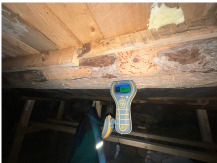
Fuktmåling i kjellerrom under kjøkken ut/inngang
