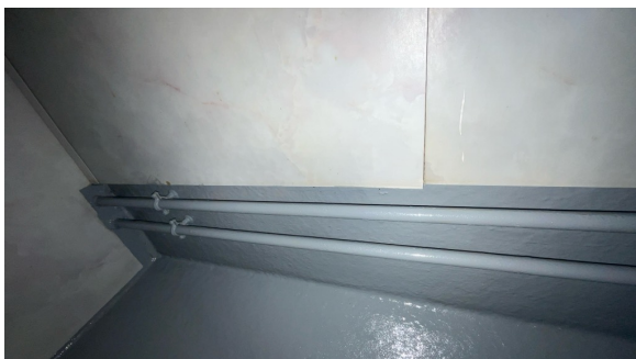
Oversiktsbilde skader i dusj
