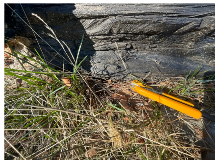
Oversiktsbilde, noe råte på østveggen
