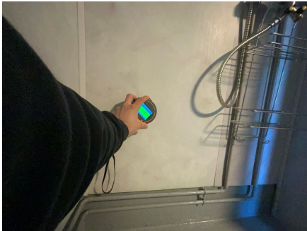
Fukt på veggoverflater
