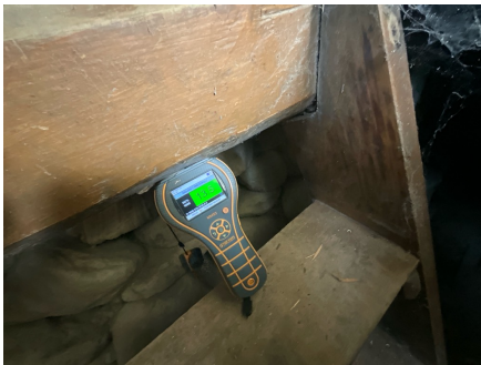
Fuktmåling i kjeller rom under stue
