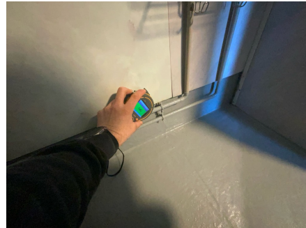
Fukt på veggoverflater
