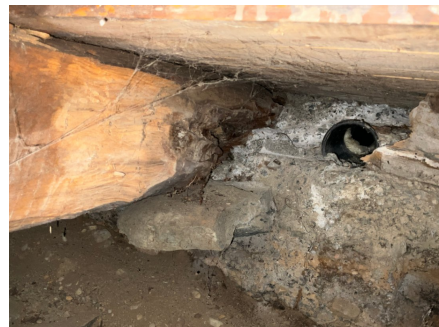
Kjeller rom under stue: Eldre råteskade på gulvbjelke/stokk
