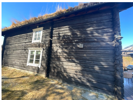
Oversiktsbilde, bunnstokk ligger i terrenget og trekker fukt.
