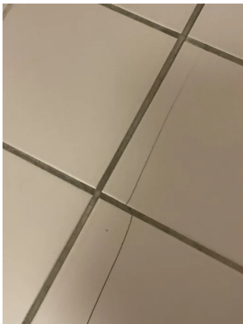
Synlige riss/ sprekker på gulvflis.
