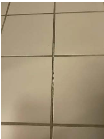
Synlige riss i sementfuger.
