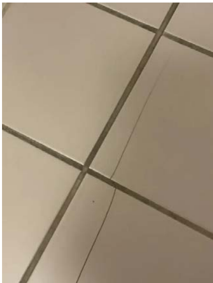
Synlige riss/ sprekker på gulvflis.
