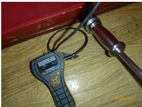
Fuktmåling delevegg kjellerstue, 30,3 %
