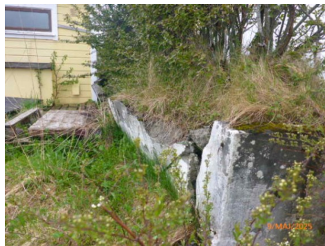
Mot øst/mot uthus, sig og skader
