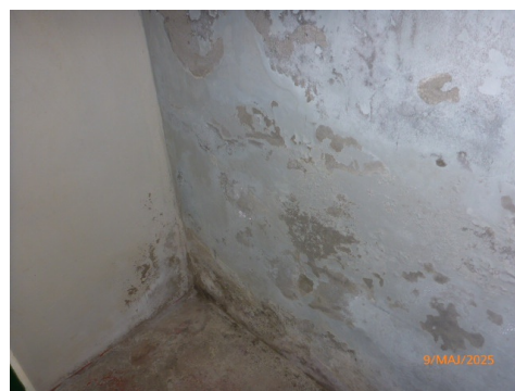
Fuktvandring i mur
