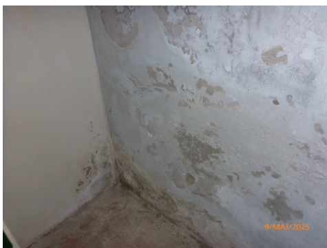
Fuktvandring i kjeller
