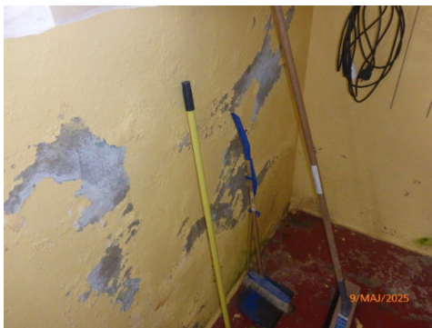
Fuktvandring i kjeller
