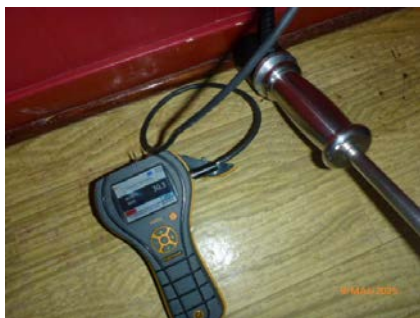
Fuktmåling delevegg kjellerstue, 30,3 %
