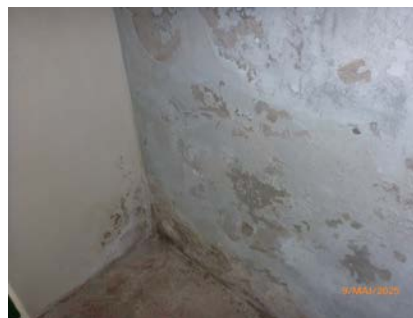
Fuktvandring i mur
