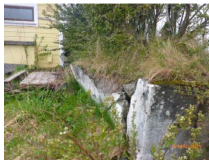
Mot øst/mot uthus, sig og skader
