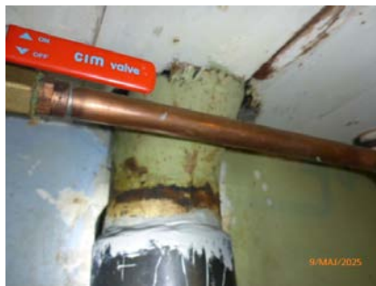
Avløpsrør fra under vaskerommet
