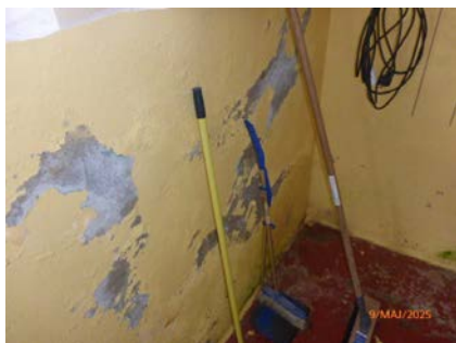
Fuktvandring i kjeller
