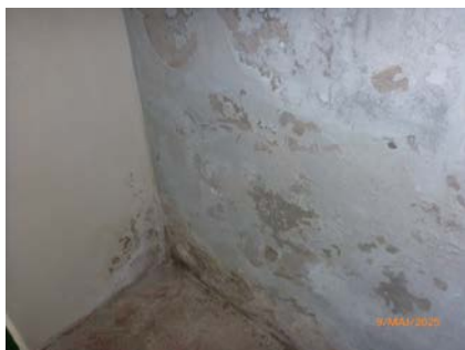
Fuktvandring i kjeller
