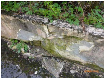
Mot nordvest, skade
