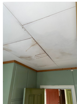
Kjøkken. Synlig vannskade i etasjeskille.
