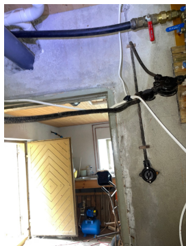
Eksempel på løse strømførende ledninger
