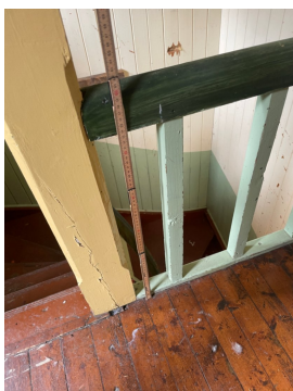
Rekkverk for lavt jmf. dagens regelverk.
