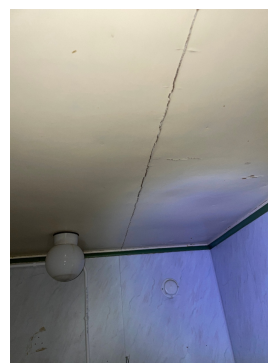
Fuktskade i etasjeskille mot loft.
