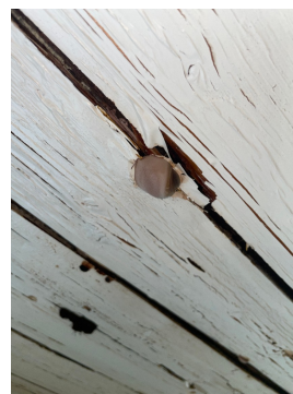
Fuktskade i trepanel i etasjeskille. Synlig soppevekst.
