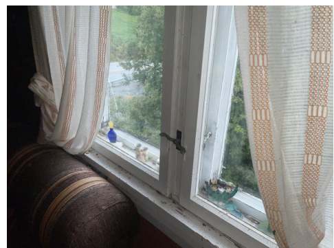
Synlig tegn på kondensering.
