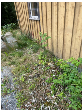
Dårlig Terrengfall på oversiden av boligen.
