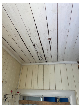
Synlig skader etter vannlekkasje og råteskadet treverk.
