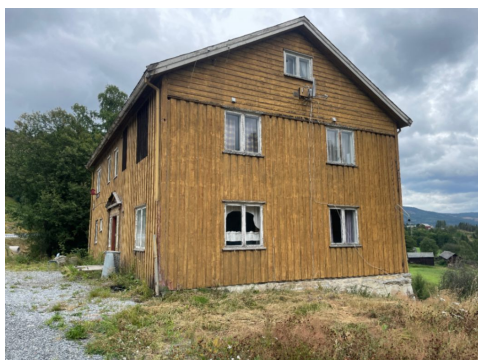
Nedsløpsrør. har skader
