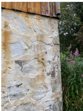
Manglende kontrollert bortledning av takvann
