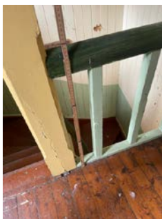
Rekkverk for lavt jmf. dagens regelverk.
