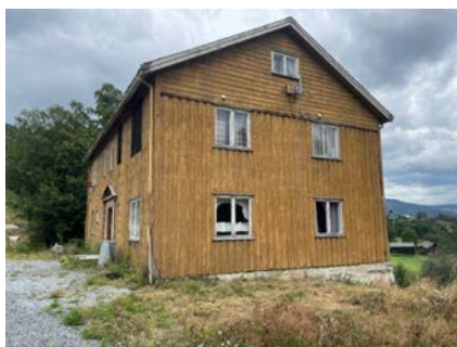
Nedsløpsrør. har skader
