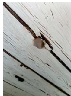
Fuktskade i trepanel i etasjeskille. Synlig soppevekst.
