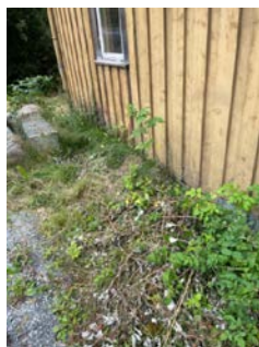
Dårlig Terrengfall på oversiden av boligen.
