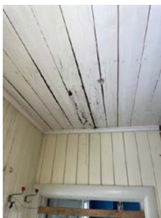
Synlig skader etter vannlekkasje og råteskadet treverk.
