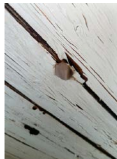
Fuktskade i trepanel i etasjeskille. Synlig soppvekst.
