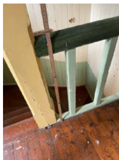
Rekkverk for lavt jmf. dagens regelverk.
