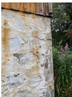
Manglende kontrollert bortledning av takvann
