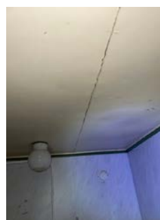
Fuktskade i etasjeskille mot loft.
