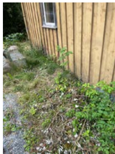
Dårlig Terrengfall på oversiden av boligen.
