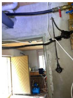
Eksempel på løse strømførende ledninger
