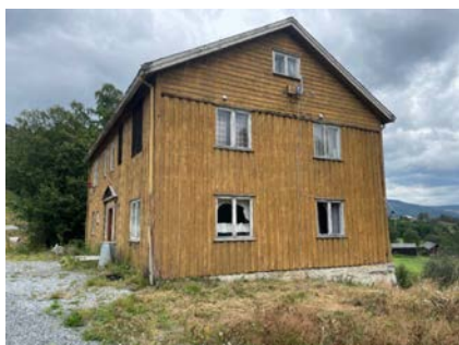
Nedsløpsrør. har skader
