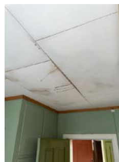
Kjøkken. Synlig vannskade i etasjeskille.
