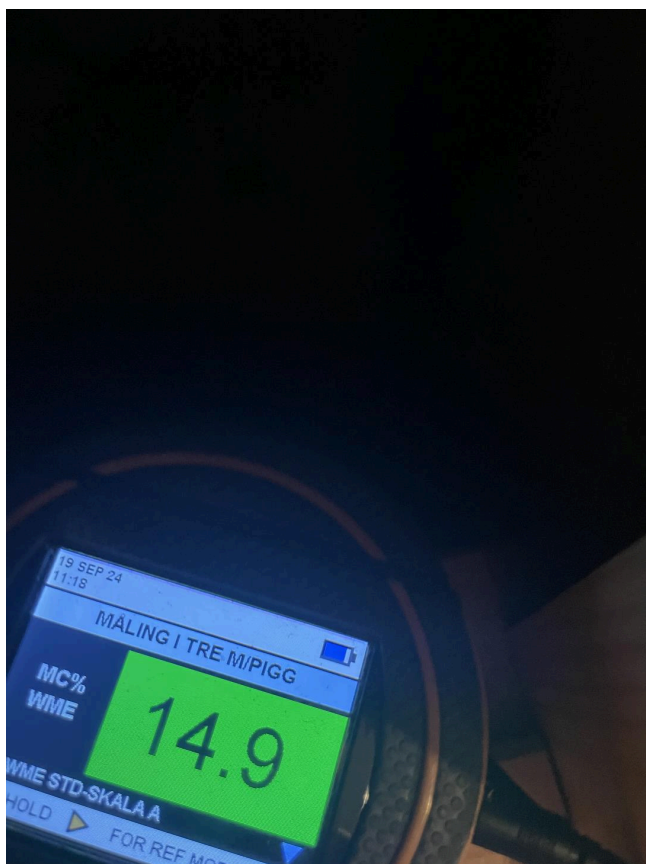
Målt verdi i utforet vegg på teknisk rom.
