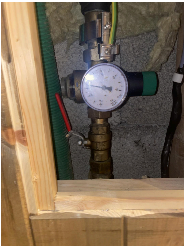
Stoppekran i utforet vegg, med trykk reduksjonsventil.
