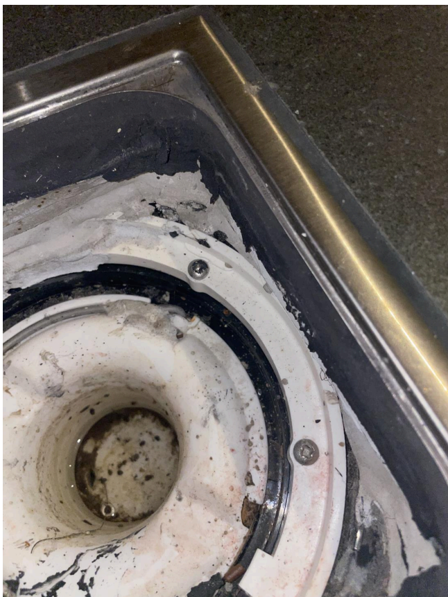
Sluk i gulv på teknisk rom.
