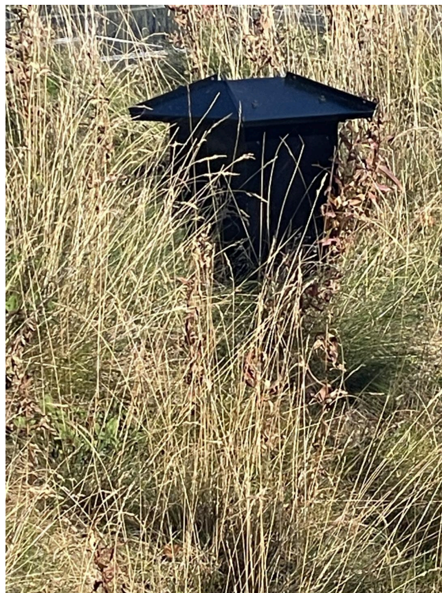
Utvendig lufte hatt for kloakk, er beslått med blikk.
