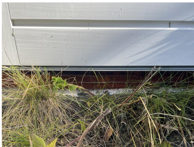
Det mangler beslag under terrassedør.
