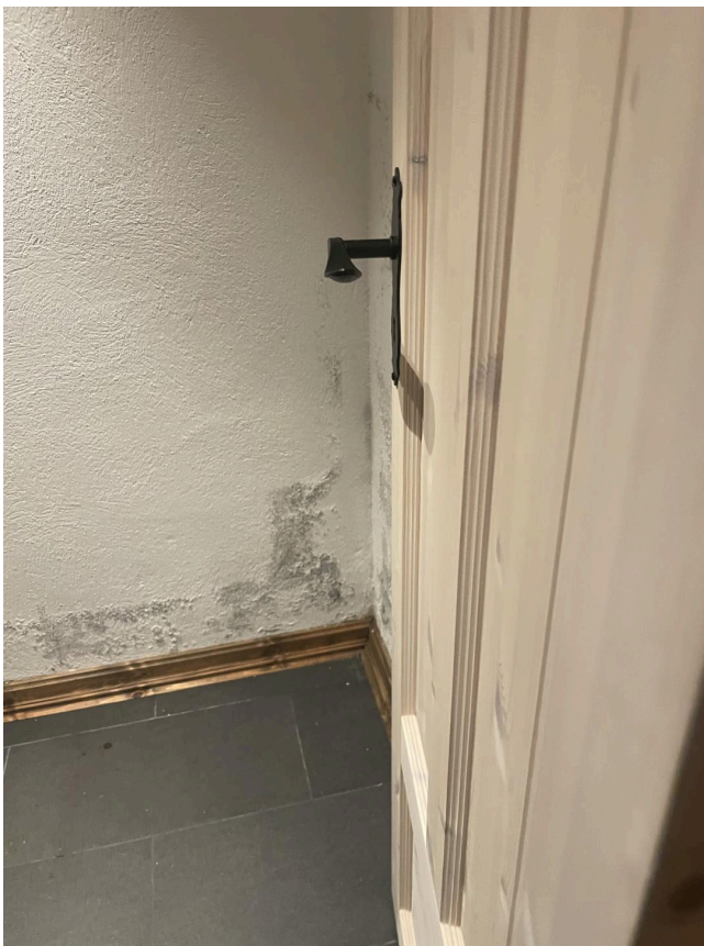
Salt/kalkutslag på yttervegg teknisk rom
