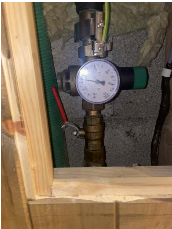
Stoppekran i utforet vegg, med trykk reduksjonsventil.
