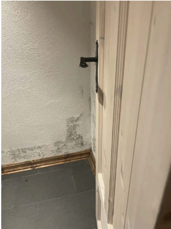
Salt/kalkutslag på yttervegg teknisk rom
