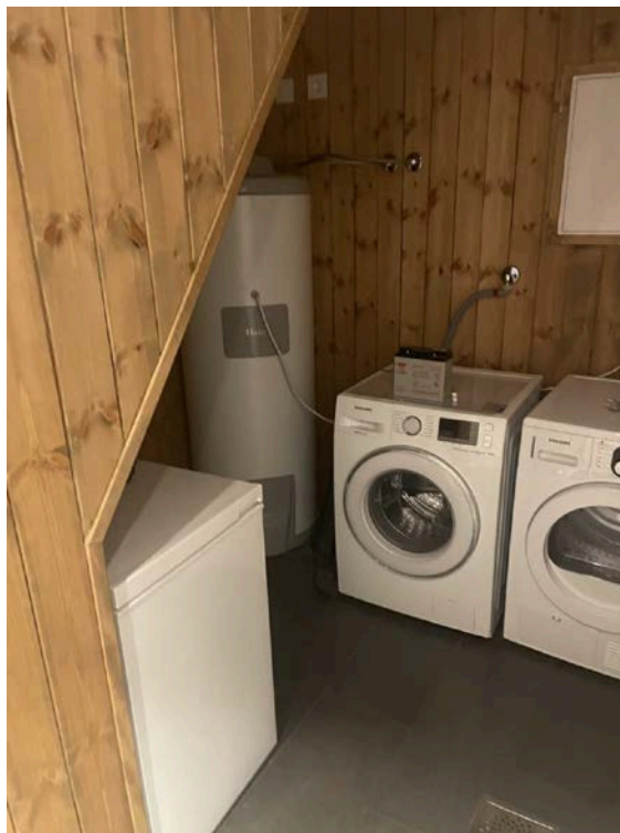
Varmtvannsbereder på teknisk rom det er opplegg for vaskemaskin i rommet.
