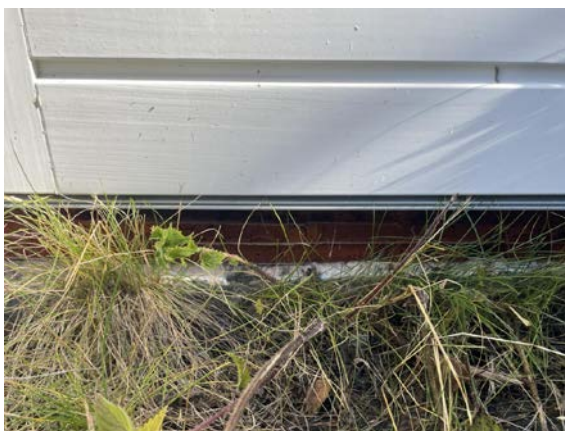
Det mangler beslag under terrassedør.
