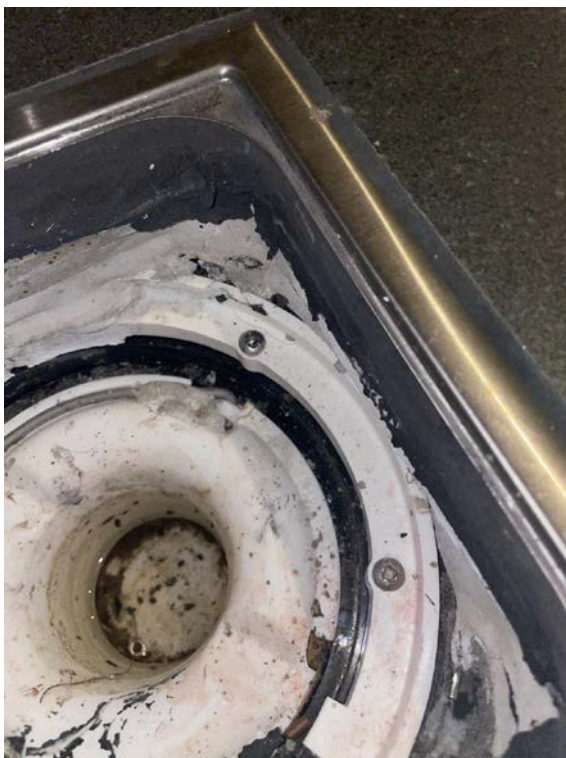
Sluk i gulv på teknisk rom.
