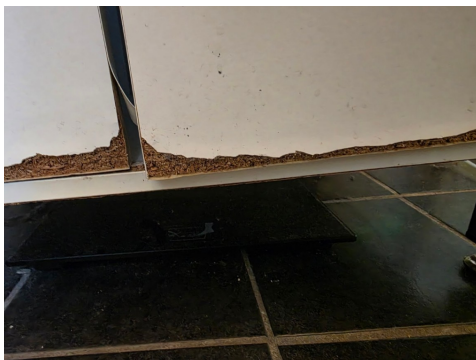
Skader på innredning
