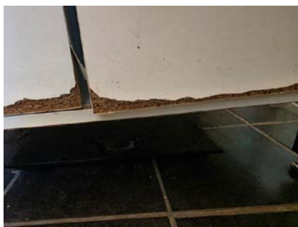
Skader på innredning
