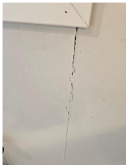
Eksempel på sprekkdannelse på kjøkken.
