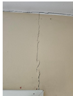
Eksempel på sprekkdannelse på soverom.
