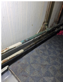
Originale kobberør med irr på bad.
