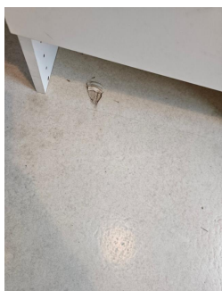
Eksempel på skade i vinylbelegg på soverom.
