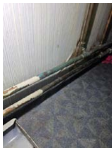
Originale kobberør med irr på bad.
