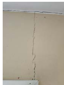
Eksempel på sprekkdannelse på soverom.
