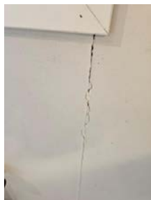
Eksempel på sprekkdannelse på kjøkken.
