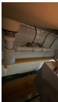
Røropplegg under vask på bad i 2. etasje.
