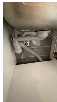
Røropplegg under skyllekar på bad/vaskerom i 1. etasje.
