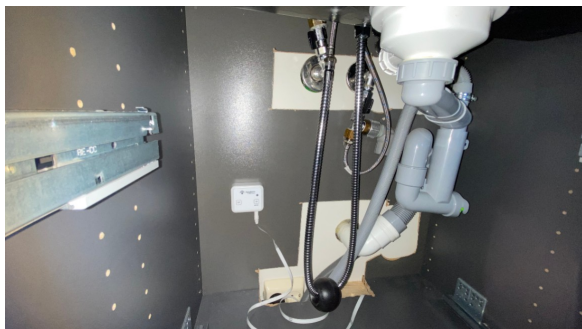
Røropplegg under kjøkkenbenk.
