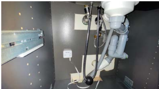
Rørapplegg under kjøkkenbenk.
