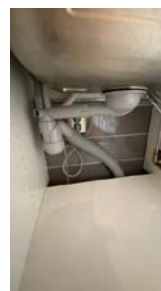
Rørapplegg under skyllekar på bad/vaskerom i 1. etasje.
