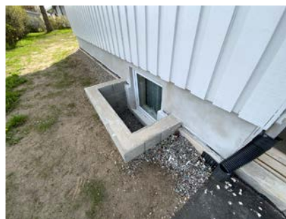
Rekkverk på lyskasser bør opparbeides.
