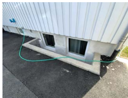
Rekkverk på lyskasser bør opparbeides.
