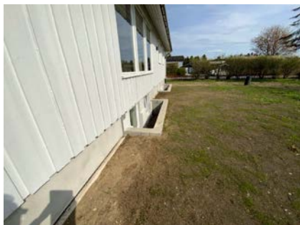
Rekkverk på lyskasser bør opparbeides.
