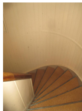
Mangler håndløper på vegg på deler av trappen.
