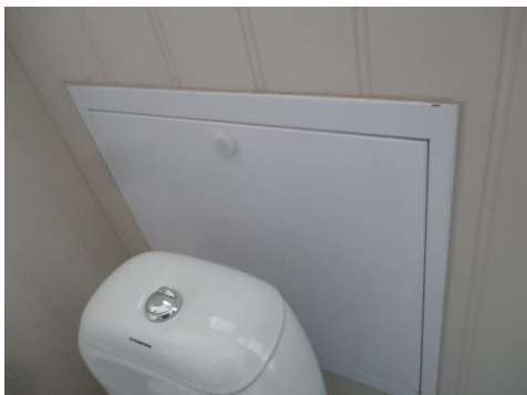
Fordelerskap på bad/vaskerom til leilighet nr:1
