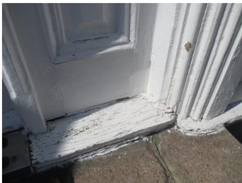
En del slitasje/skader på karm og ramme.
