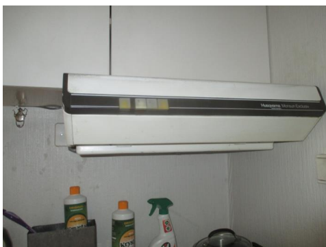
Eldre ventilator over komfyr.
