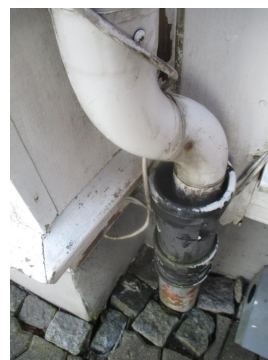
Takvann er blitt ledet bort i fra grunnmur.
