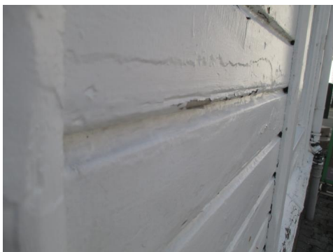
Eldre kledning bærer noe preg av slitasje og elde.
