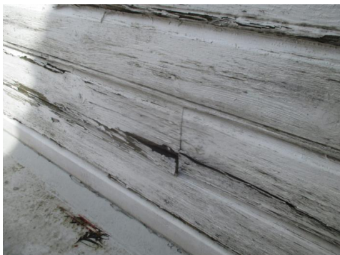
Råteskader på rekkverk i mot gate.
