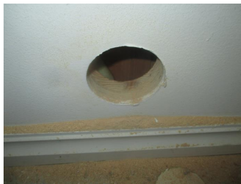
Hulltaking i gangen i mot dusjhjørne.
