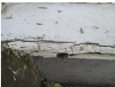
Noe råteskader på bunnstokk for kledning.
