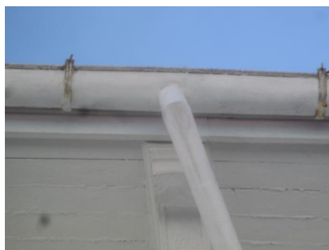
Noe rust på rennekroker.
