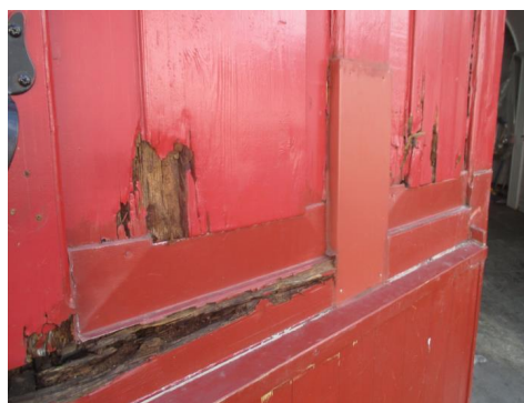
Port har fått en del råteskader.
