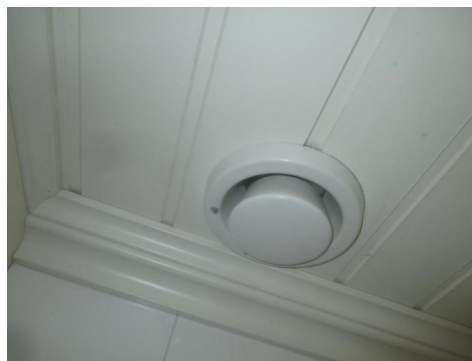
Avtrekk i himling.
