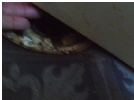
Sluk ved dusjkabinett
