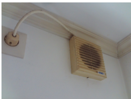
Eldre vifte i ytterveggen.
