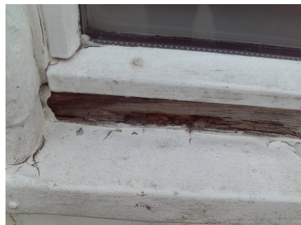
Råteskader i stort vindu i første etasje.
