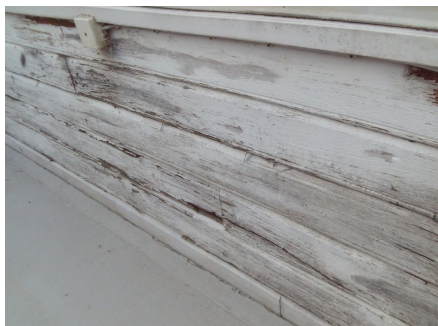
Større råteskader i rekkverk i leilighet nummer 1
