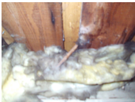
Ingen lufting i mellom undertak og isolasjon.
