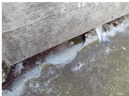
Tekking har sprukket opp.
