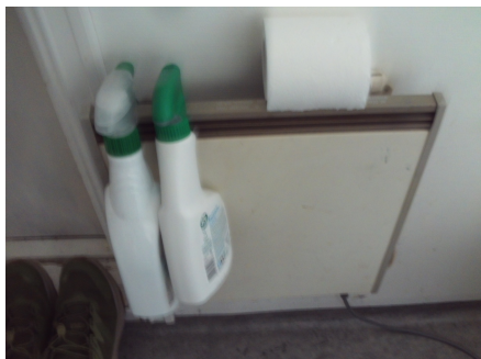
Panelovn som varmekilde.
