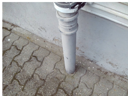
Takvann er ledet bort i grunnmur.
