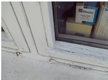
Større slitasje på utvendig karm og ramme.
