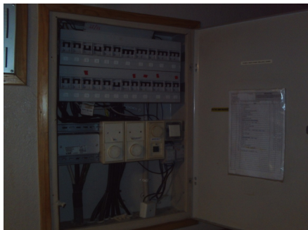
Sikringsskap i kjeller.
