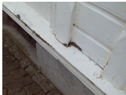
Ingen lufting bak kledningen.
