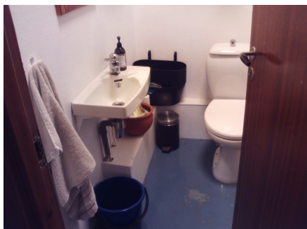
Deler av toalettrom i forettningsdelen.
