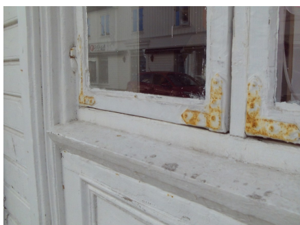
Gamle vinduer i deler av første etasje
