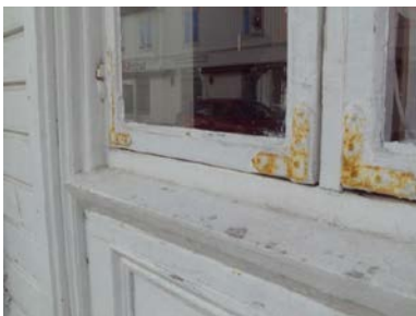
Gamle vinduer i deler av første etasje
