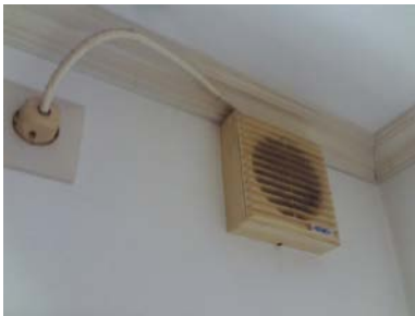
Eldre vifte i ytterveggen.
