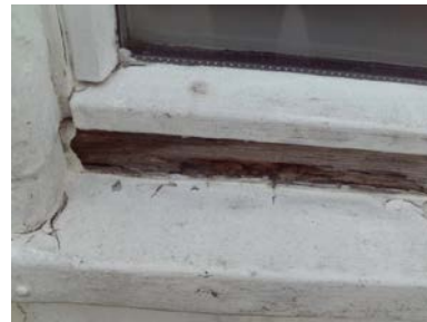
Råteskader i stort vindu i første etasje.
