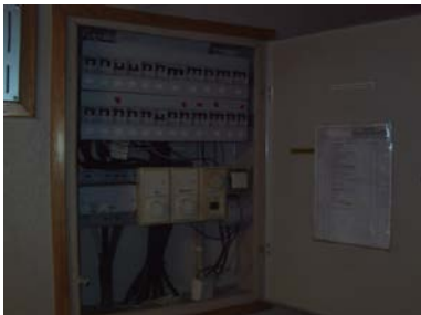
Sikringsskap i kjeller.
