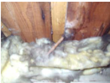
Ingen lufting i mellom undertak og isolasjon.
