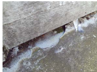
Tekking har sprukket opp.
