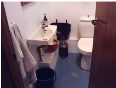
Deler av toalettrom i forettningsdelen.
