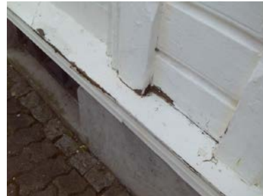
Ingen lufting bak kledningen.
