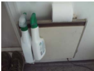
Panelovn som varmekilde.
