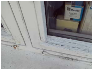
Større slitasje på utvendig karm og ramme.
