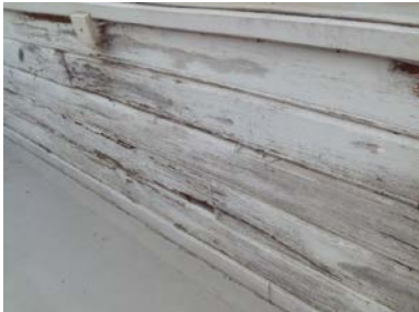
Større råteskader i rekkverk i leilighet nummer 1
