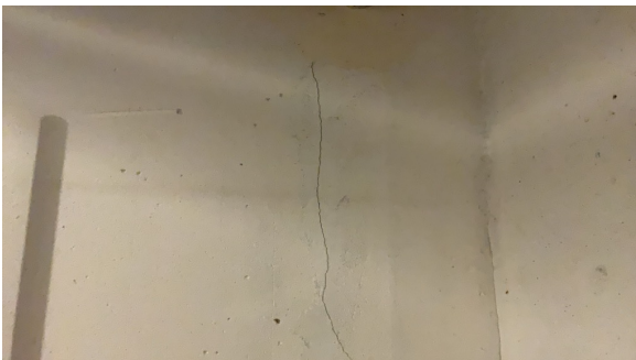
Sprekker i mur registrert.
