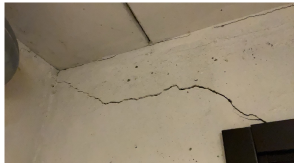
Sprekker i mur registrert.
