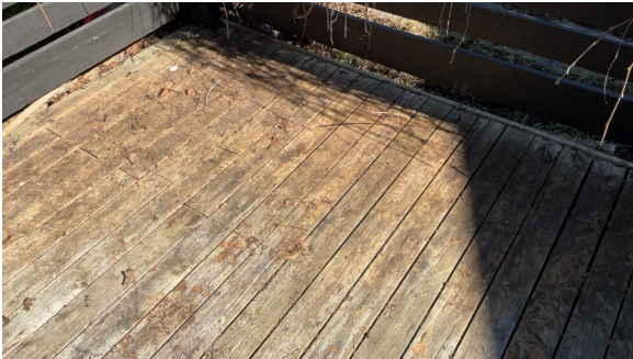
Slitasje på overflater.
