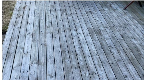
Slitasje på overflater.
