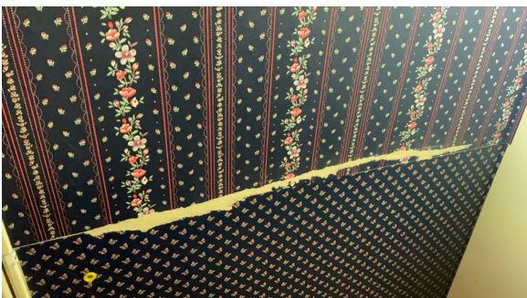
Slitasje på overflater.
