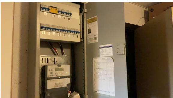
Sikringsskap plassert i bod.
