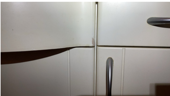
Sår/hakk på innredning.
