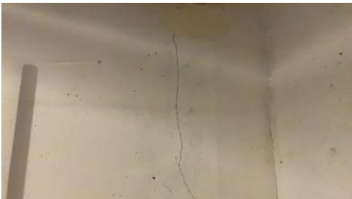
Sprekker i mur registrert.
