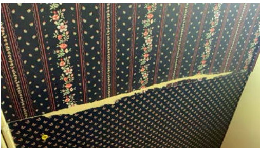
Slitasje på overflater.
