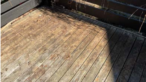
Slitasje på overflater.
