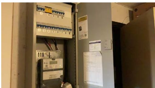
Sikringsskap plassert i bod.
