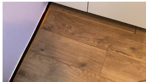
Ufagmessig utførelse på laminatgulv.
