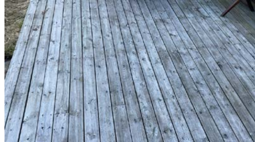
Slitasje på overflater.
