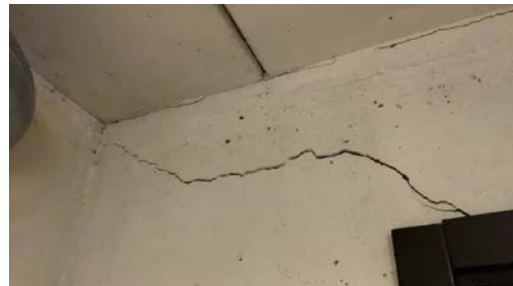
Sprekker i mur registrert.
