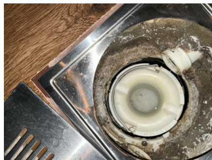
Kontroll av hovedsluk.
