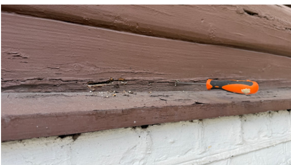
Spredte råteskader i bunnstokk
