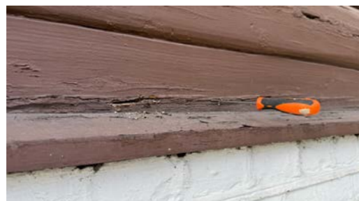
Spredte råteskader i bunnstokk
