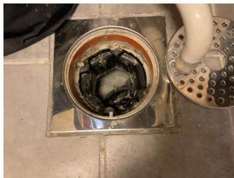
Sluk med synlig membran.
