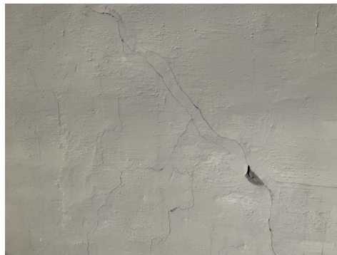
Skråriss i vegg mot sørøst.
