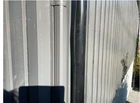
Frostsprengning på nedløpsrør.
