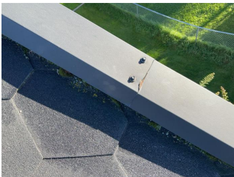
Rust på beslag på vindskier.
