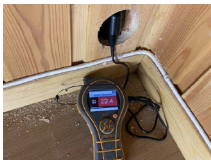
Fuktmåling i konstruksjon i kjellerstuen.
