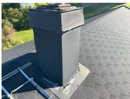
Rust og manglende maling på pipebeslag og luftehatt.
