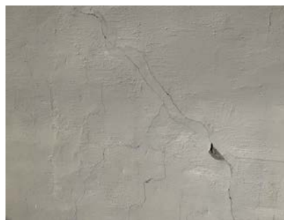
Skråriss i vegg mot sørøst.
