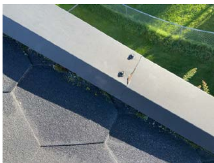
Rust på beslag på vindskier.
