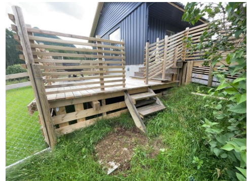
Trapp ned fra veranda til hage/inngjerdning, det er anbefalt med håndløper
