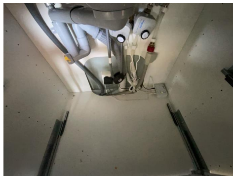
Vannstoppventiler med følere på varmt og kaldt vann under vask på kjøkkenet.
