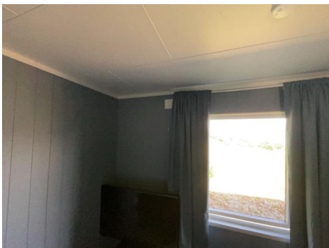
Ventil i vegg på soverom 1
