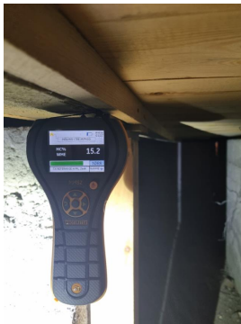
Fuktkontroll i krypkjeller i nedre del av bolig. Fuktmåling viser 15,2%
