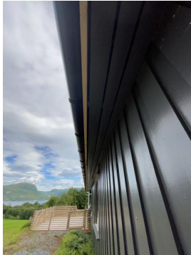
Synlige luftespalter i overgang tak/vegg
