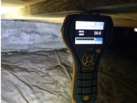
Fuktkontroll i krypkjeller like ved luke ned til krypkjeller. Fuktmåling viser 16,6%
