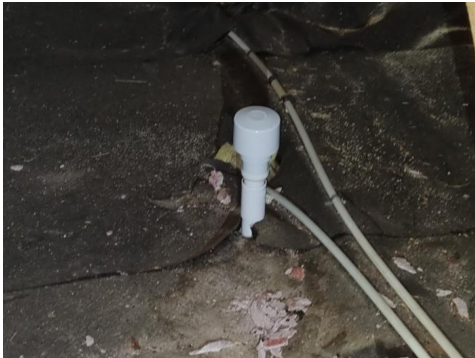
Lufteventil avløp er plassert på kryploft
