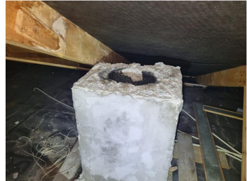
Rest av pipe som er synlig på kryploft
