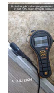
Kontroll av gulv mellom gang og vaskerom. Det er målt 7,8 %, ingen forhøyde fuktavvik
