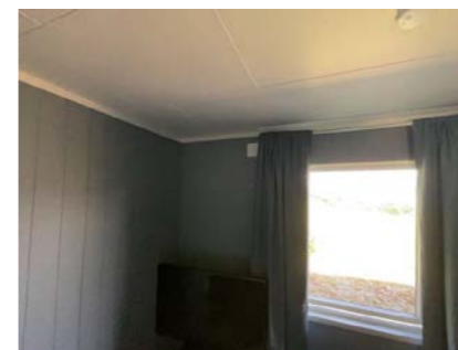
Ventil i vegg på soverom 1
