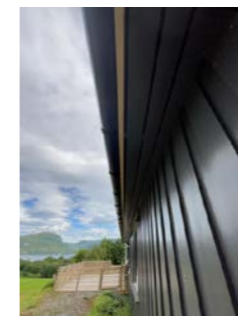
Synlige luftespalter i overgang tak/vegg
