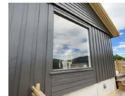
Vindu på stue er punktert
