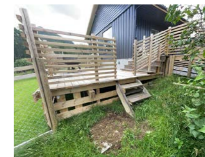
Trapp ned fra veranda til hage/inngjerdning, det er anbefalt med håndløper
