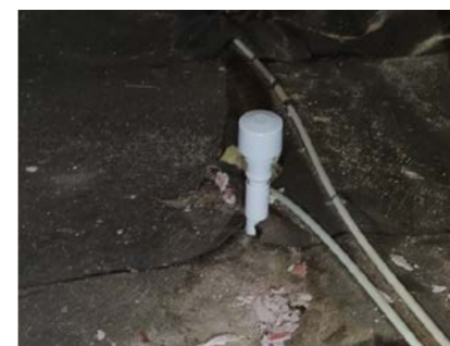
Lufteventil avløp er plassert på kryploft
