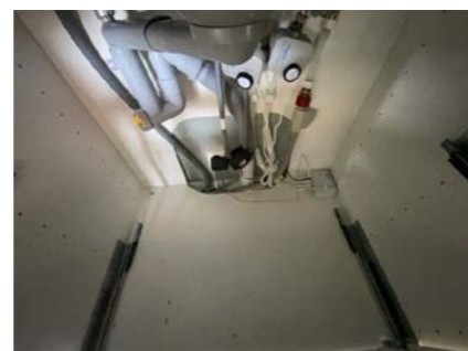
Vannstoppventiler med følere på varmt og kaldt vann under vask på kjøkken.
