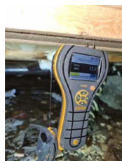
Fuktkontroll i krypkjeller i like ved avløpsrør under bad/vaskerom. Fuktmåling viser 17,2%
