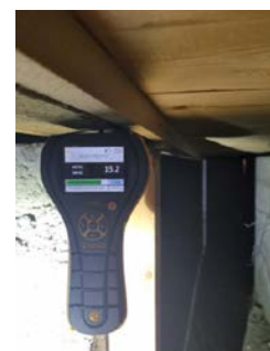
Fuktkontroll i krypkjeller i nedre del av bolig. Fuktmåling viser 15,2%
