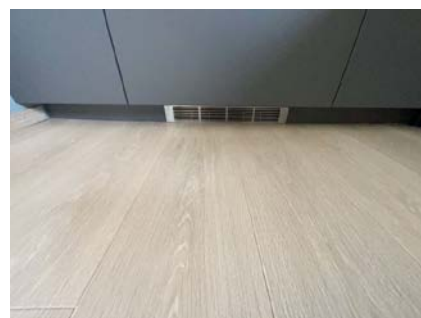
Rist for avkast av luft fra ventilator i sokkel
