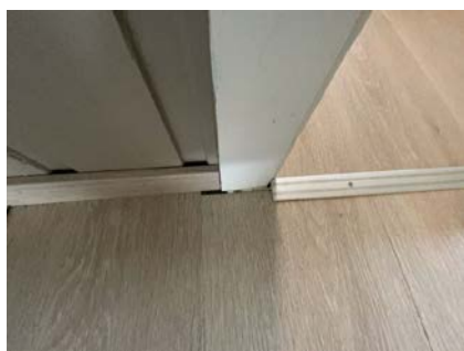
Manglende tilpasning ved døråpning i gang mot vindfang.
