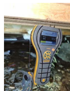
Fuktkontroll i krypkjeller i like ved avløpsrør under bad/vaskerom. Fuktmåling viser 17,2%
