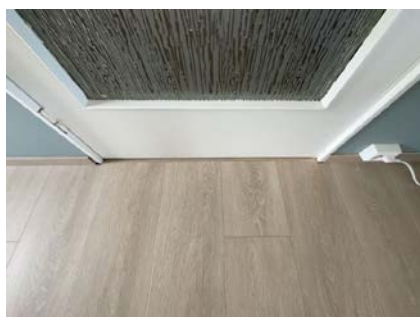
Manglende tilpasning ved døråpning på stue/kjøkken mot gang.
