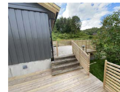
Trapp mellom nivå på veranda. Det er anbefalt med håndløper på begge sider.
