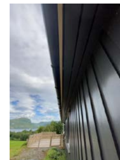
Synlige luftespalter i overgang tak/vegg
