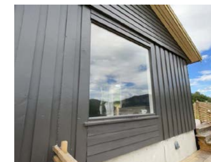
Vindu på stue er punktert
