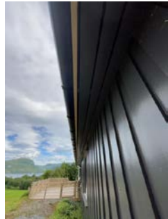
Synlige luftespalter i overgang tak/vegg
