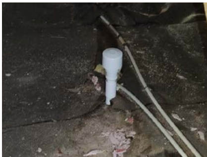
Luftventil avløp er plassert på kryploft
