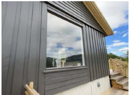
Vindu på stue er punktert
