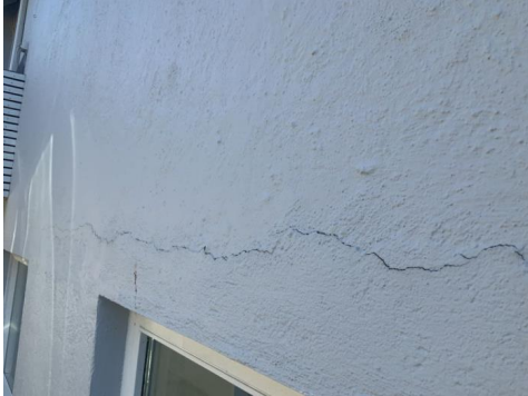
Riss i pussede flater over vindu.
