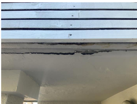
Bilde viser sprekk i betongpussen under overliggende balkong.
