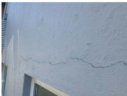
Riss i pussede flater over vindu.
