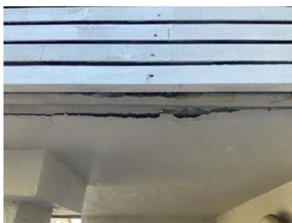
Bilde viser sprekk i betongpussen under overliggende balkong.
